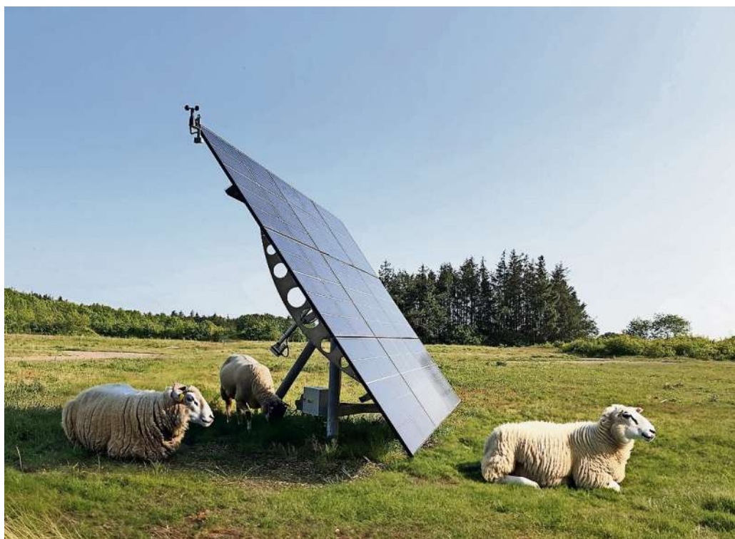
Dem Sonnenlicht nachgeführte PV-Module ergeben rund 30 Prozent mehr Stromertrag.
