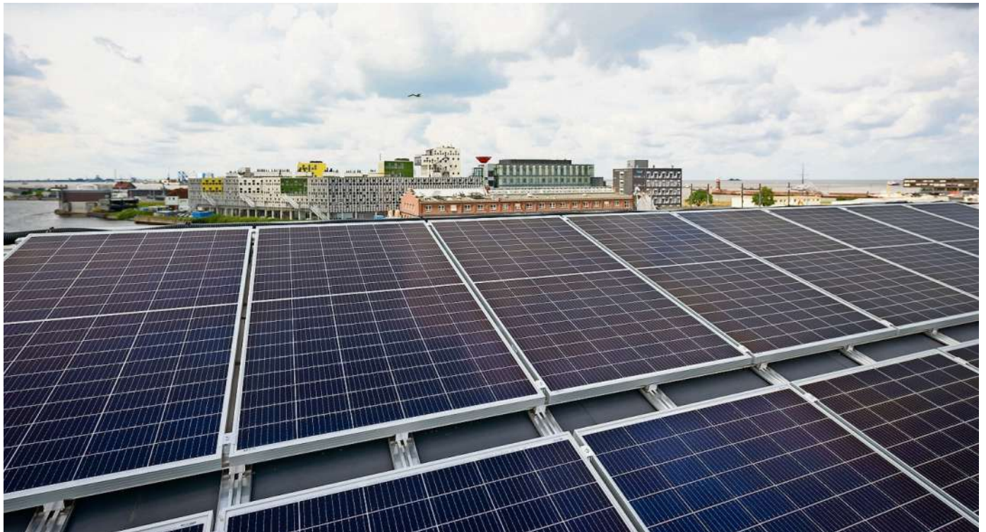
Photovoltaik auf dem ehemaligen Nordsee-Gebäude, das nach der umfassenden Sanierung vom AWI genutzt wird.
