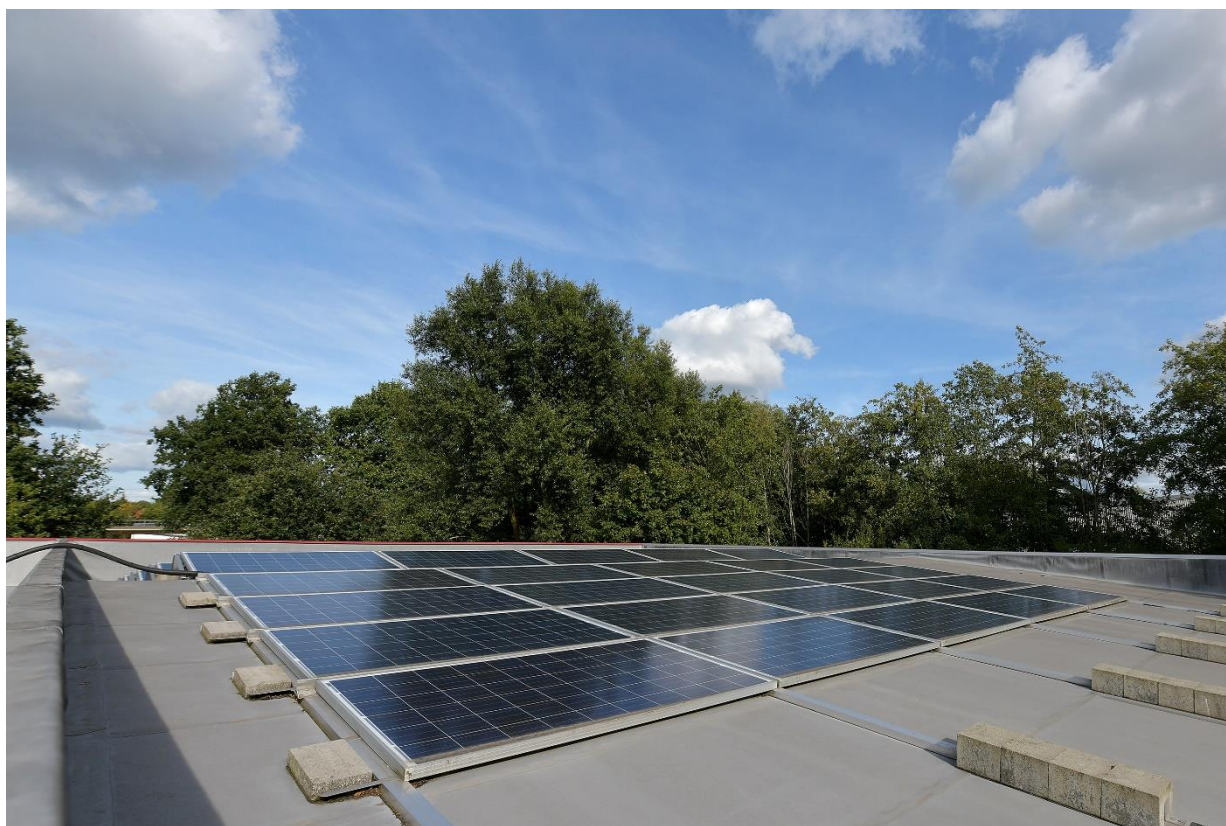
Bildunterschrift: Große Dachflächen und hoher Strombedarf während des Tages – für viele Unternehmen lohnt sich Photovoltaik auch finanziell (Foto: energiekonsens, Fotograf: Michael Bahlo)
