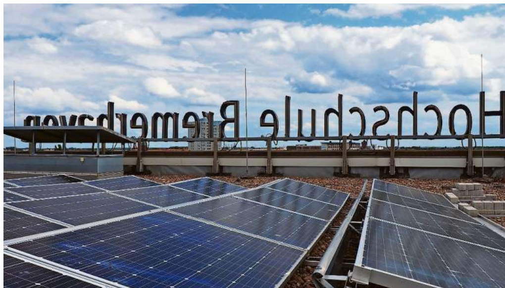
Klimaschutz mit Ausblick: PV-Anlagen auf dem Dach der Hochschule Bremerhaven.
