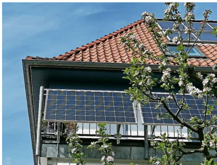
Die Befestigung der kleinen Sonnenstromkraftwerke muss vorschriftsmäßig sein; gerade in unserer Region ist die Windlast groß. Foto: energiekonsens
