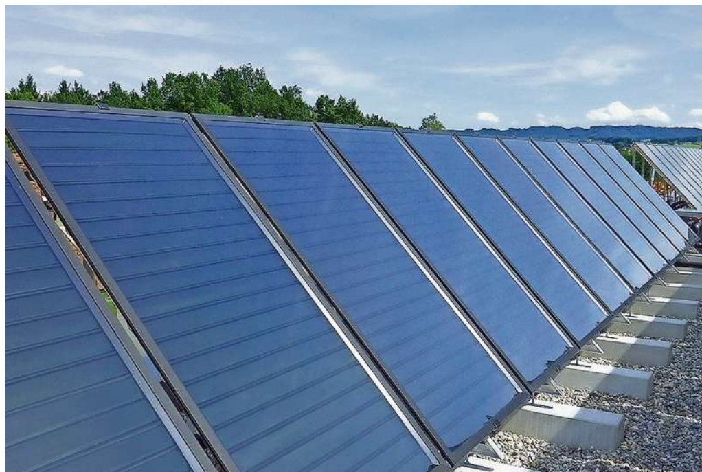
Solarthermie ist flächendeckend in Deutschland einsetzbar - und kann damit eine günstige Basiswärmequelle sein. Auf Flachdächern werden die Kollektoren, wie auf dem Foto zu sehen, aufgestellt, um so die Effizienz zu steigern. Fotos: Thermosolar
