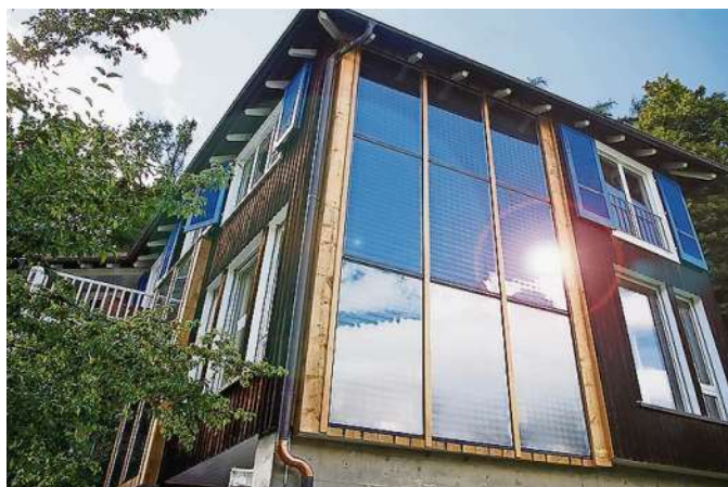
Thermische Solaranlagen können auch als Gestaltungselemente senkrecht in die Fassade eines Hauses eingebaut werden.
