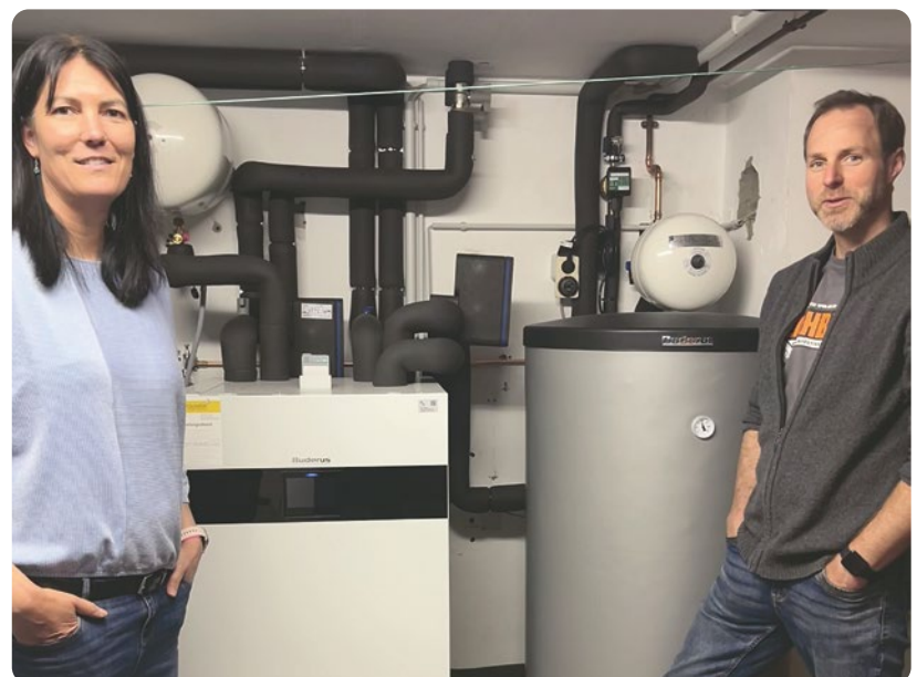
Auch die Wärmepumpe als Monoblock in der Außenaufstellung braucht Platz für die Inneneinheit und Speicher im Haus.
