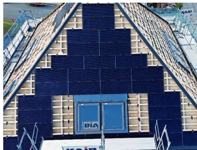
Dach und Solaranlage in einem: Die Indach-PV-Module füllen sich direkt in die Dachfläche ein. Foto: energiekonsens
