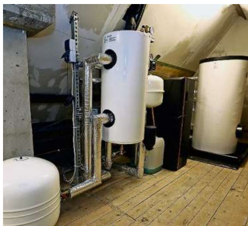
Kompakt untergebracht: Die neue Wärmepumpentechnik befindet sich auf dem Dachboden.
