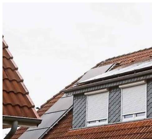
Strom und Wärme vom Dach: PVT-Module verbinden Photovoltaik und Solarthermie.
